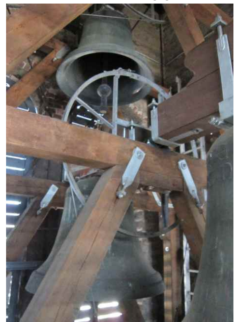
Beim Blick in den restaurierten Glockenstuhl sieht man links oben die kleine, darunter die mittelgroße und rechts die große Glocke.
